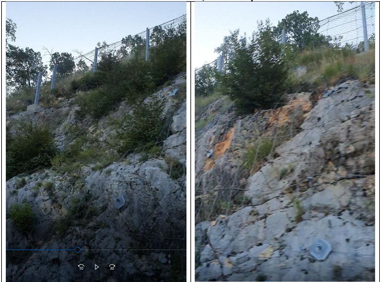
NEPROMIJENJENO STANJE; sanaciona mjera br. 8
