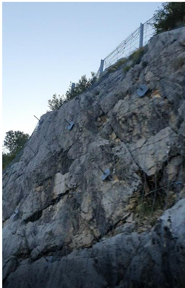
NEPROMIJENJENO STANJE; sanaciona mjera br. 9
