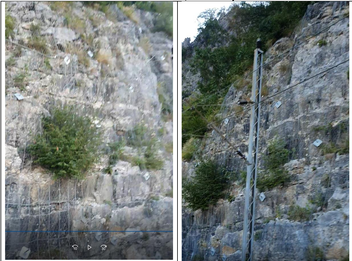
NEPROMIJENJENO STANJE; sanaciona mjera br. 18
