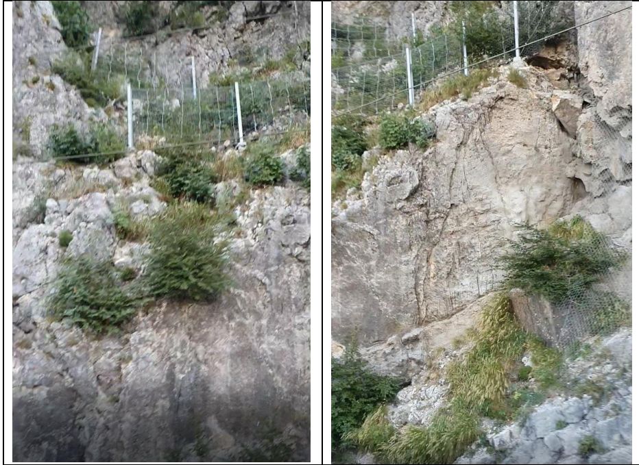
NEPROMIJENJENO STANJE; sanaciona mjera br. 14
