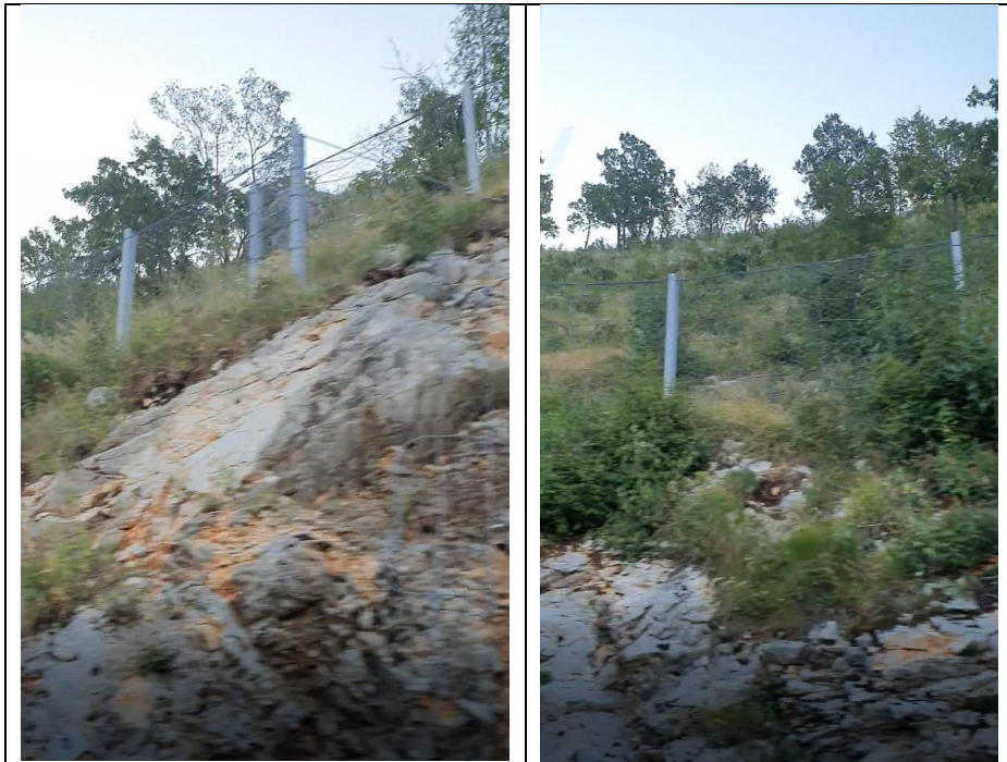
NEPROMIJENJENO STANJE; sanaciona mjera br. 7
