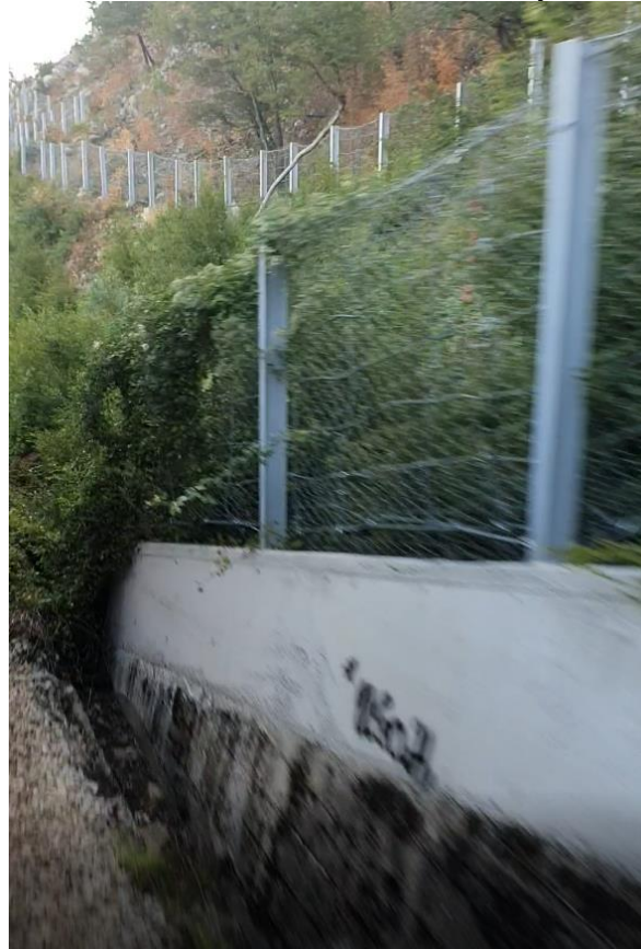
NEPROMIJENJENO STANJE; sanaciona mjera br. 4
