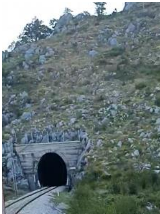
NEPROMIJENJENO STANJE; sanaciona mjera br. 5
