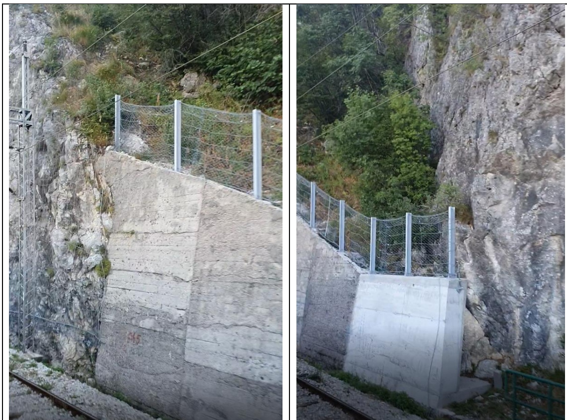
NEPROMIJENJENO STANJE; sanaciona mjera br. 10
