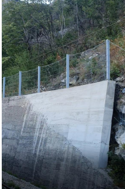
NEPROMIJENJENO STANJE; sanaciona mjera br. 7
