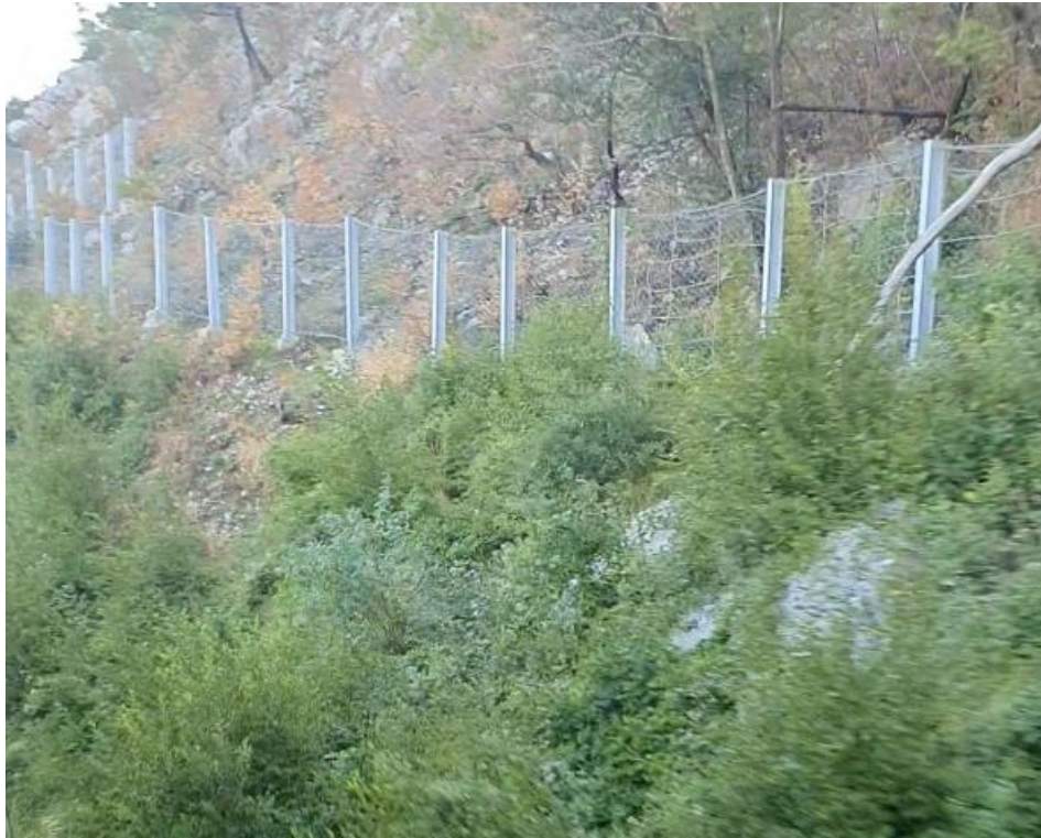
NEPROMIJENJENO STANJE; sanaciona mjera br. 3
