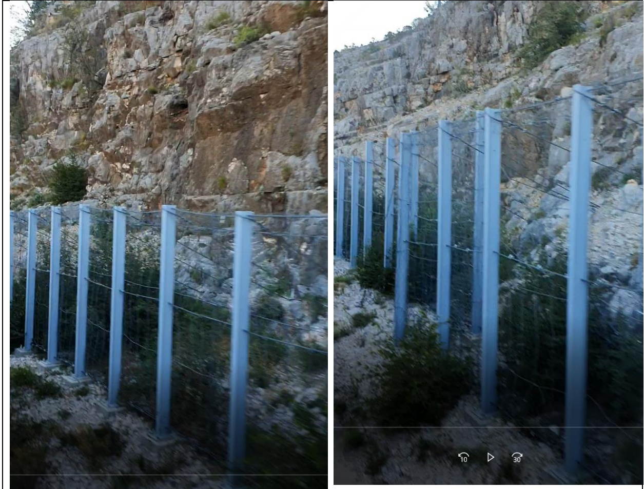
NEPROMIJENJENO STANJE; sanaciona mjera br. 5
